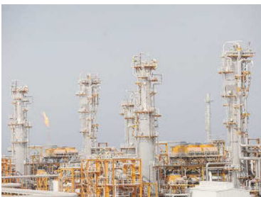
● پالایشگاه دهم ● محل پروژه: بوشهر - عسلویه
